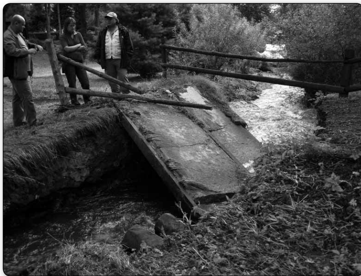
Velká voda vzala i dva mostky v Kyjově, jedním z nich byl mostek pod panem Hiekem.
